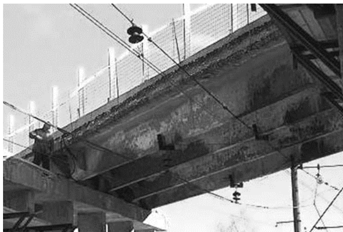
Рисунок 7 - Разрушение бетона пролетного строения
