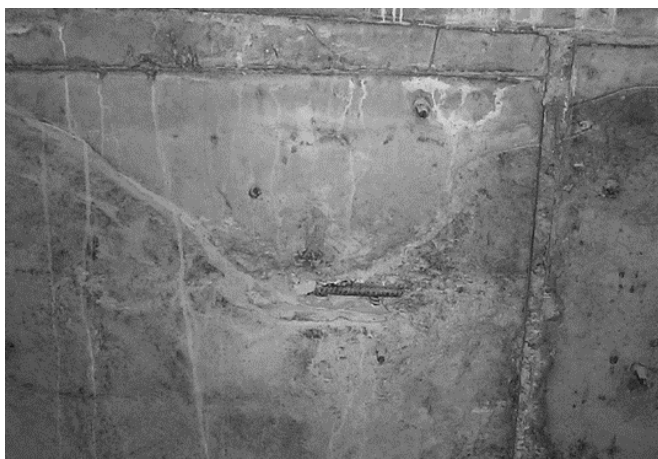
Рисунок 1 - Участок стены с оголенной арматурой
