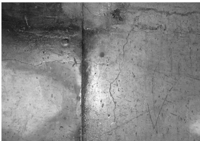
Рисунок 6 -Усадочные трещины на поверхности стены автодорожного тоннеля
