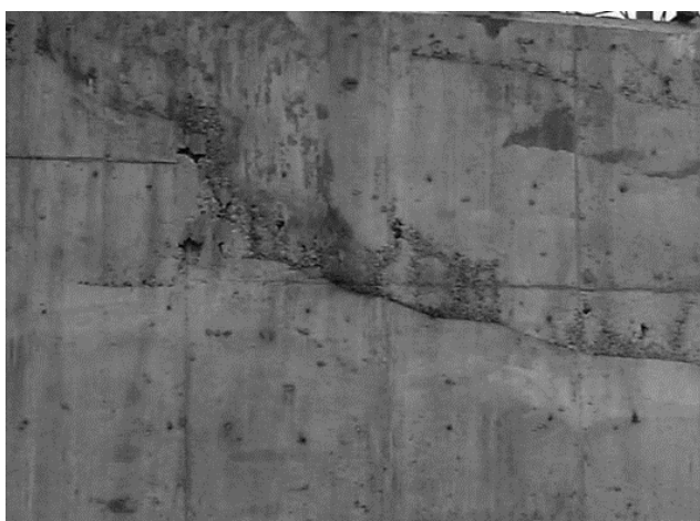
Рисунок 3 - Щербенистость на поверхности стены и полости, незаполненные бетоном
